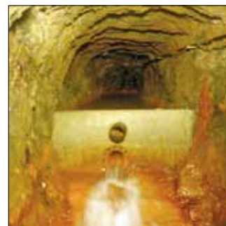
"La grosse venue" (cette eau sera traitée dans l'usine)
