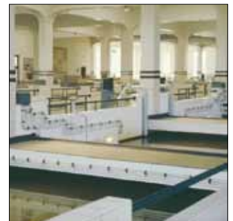
Salle des filtres
