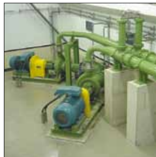
Salle des pompes à - 130 m
