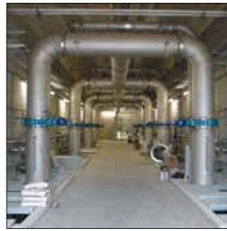
Postfiltratie: buizen met water en met lucht voor het spoelen van de filters
