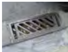
De rioolkolken die het afvloeiende regenwater opvangen
